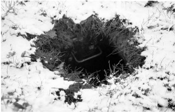
Abb. 34: Aller 100 m war ein gemauerter Kontrollschacht vorhanden. Der Durchmesser des Kanals betrug 0,80m. Die Kontrollschächte waren nicht abgedeckt und im Unterholz kaum zu erkennen.
