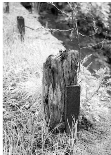
Abb. 62: Überreste der Anfang 1942 angebauten hölzernen Brüstung. Diese Ausführung war ab Mitte 1941 wegen der Verknappung von Rohstoffen zulässig. Der GI erließ aus diesem Grund eine genormte Musterzeichnung, die einen Baustandard vorgab.
