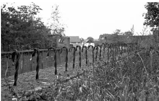
Abb. 42: Bewehrungsseisen oberhalb der Widerlagerbänke am BW 33. Zum Zeitpunkt des Abbruchs der Arbeiten muss das Lehrgerüst noch am Bauwerk gestanden haben. Im Umfeld des Bauwerkes konnten keine Spuren von Werksteinen gefunden werden. Die Auswertung der Spuren ergab, dass über diese Baulücke in der Bauzeit Herbst 1941 bis März 1942 keine Feldbahngleise verlegt waren.
